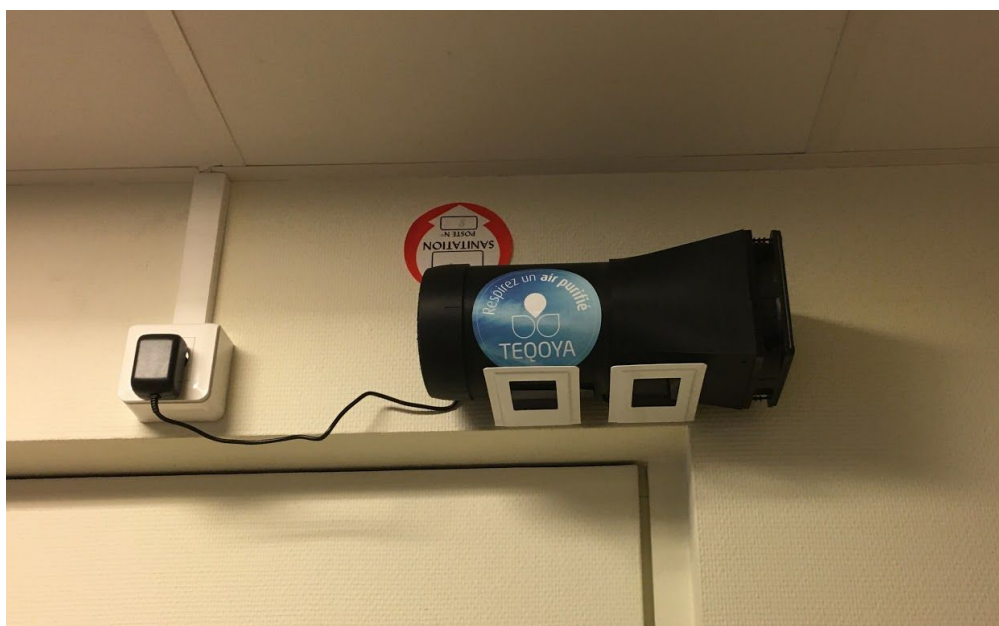
Purificateur d'air CYCLO tel qu'installé temporairement dans la crèche Marguerite Le Maut
